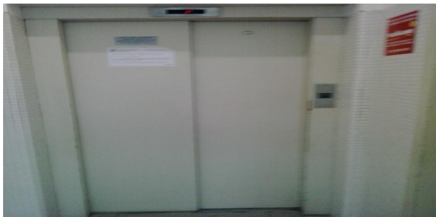
Figura 6: Um dos elevadores de acesso ao piso superior
